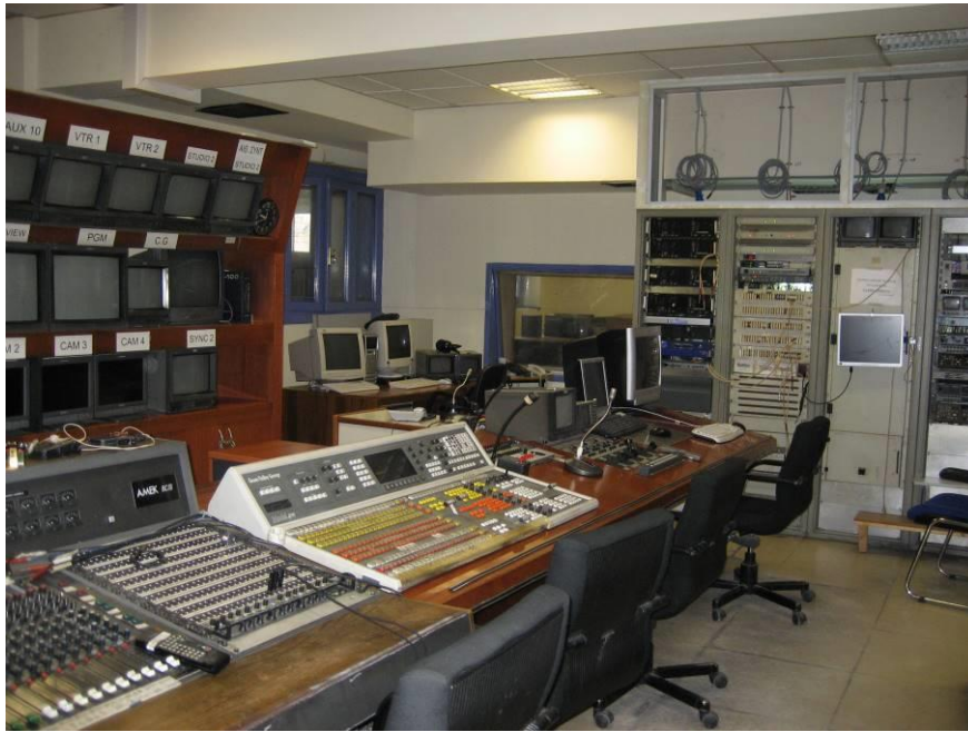
Εικόνα 5 Χώρος ελέγχου 1 EPT 3
